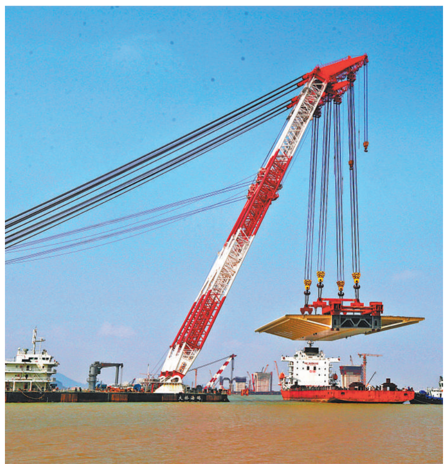
3月14日，由中铁大桥局承建的珠海珠机城际铁路金海大桥首个边跨（横琴侧）钢梁成功合龙。大桥建成后，将成为内地联系澳门、香港的重要客运通道。
