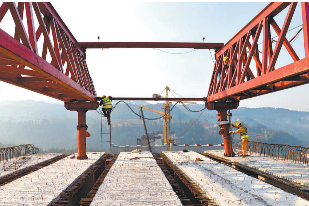
2月6日，四川省巴中市通江县，由四川公路桥梁建设集团有限公司机械化施工分公司承建的镇广高速王坪至通江段，工人正在进行T型梁架设。镇广高速王坪至通江段项目建成后，从通江县城至川陕革命根据地红军烈士陵园车程将由1小时缩短到15分钟左右。程聪摄(中经视觉)
