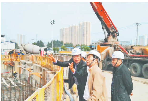
侯保荣(中)现场调研设施腐蚀情况。(中国科学院海洋研究所供图)
