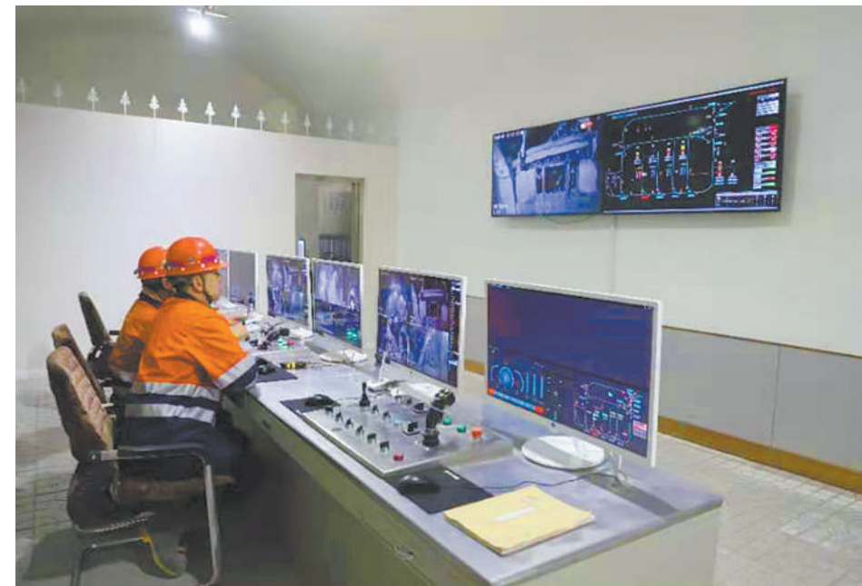
金川集团三矿区井下无人驾驶有轨矿运车操作间,工人正在远程操控。(资料图片)
