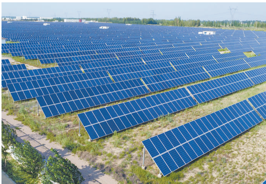
内蒙古巴彦淖尔磴口县的“光伏+”治沙效果显著，在光伏板下面及附近的植被长势良好。
