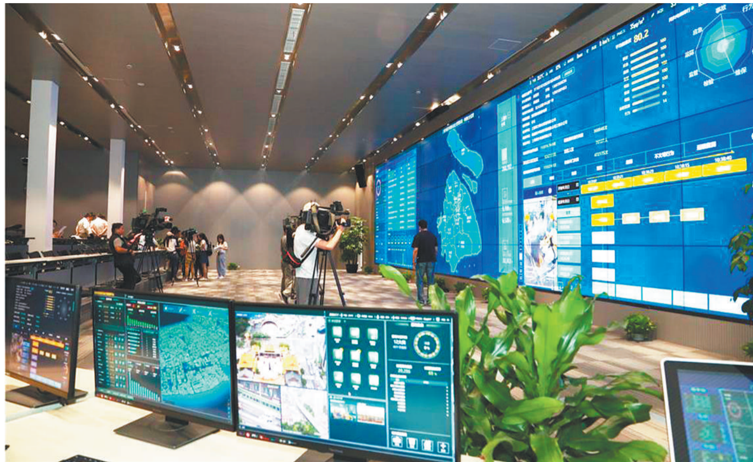
上海市城市网格化综合管理系统大屏幕上实时显示电梯安全运行情况。
