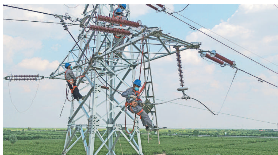
7月10日，国网山东滨州沾化区供电公司线路施工人员正在110千伏黄线22号铁塔上作业，提升重点工程建设质效，服务迎峰度夏。中电联最近发布的报告预计，2020年全年全社会用电量为7.38万亿至7.45万亿千瓦时，同比增长2%至3%。国家电网上调投资计划，加快开复工电网工程，确保电力需求得到满足。曹林摄(中经视觉)
