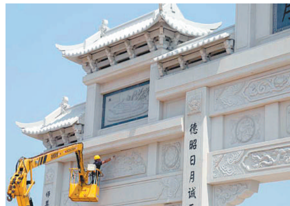
图为江西崇仁县宝水新区海绵城市综合体(一期)森林公园项目,工作人员在完善公园入口处的牌楼建设。该森林公园将民间文化、产业文化融为一体,努力打造生态旅游的新品牌。朱斌摄(中经视觉)
