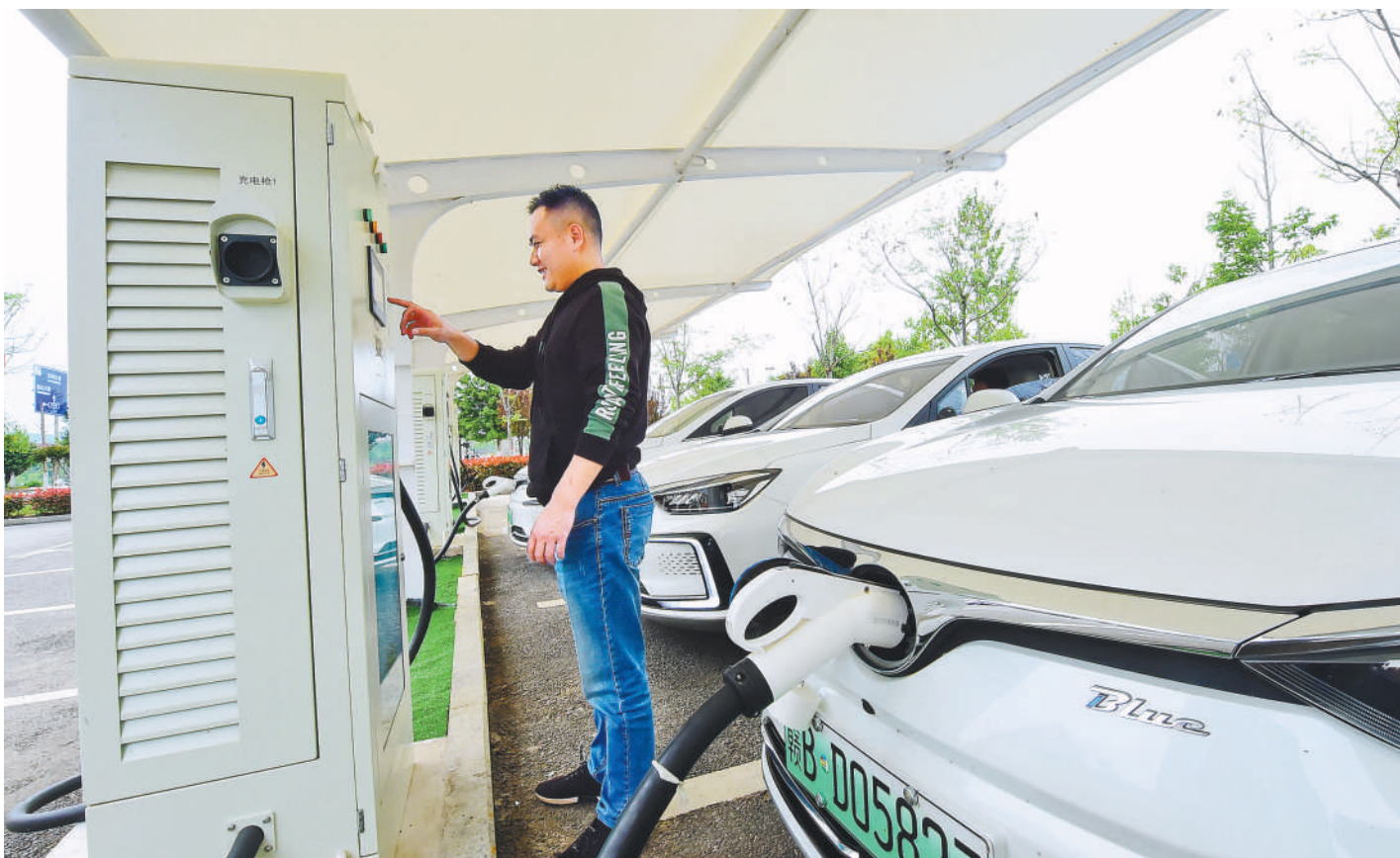
3月27日,在江西省赣州市会昌县月亮湾新区新能源汽车充电站,员工在给车辆充电。会昌县引进新能源汽车服务公司,安装直流快充充电桩12个,交流充电桩97个,方便市民出行。朱海鹏摄(中经视觉)
