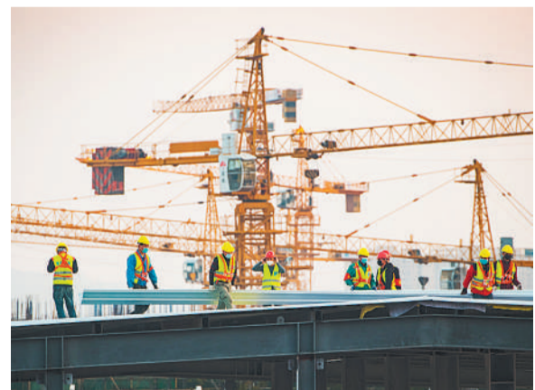
北斗高精度定位设备为武汉雷神山医院迅速施工争取了宝贵时间，图为医院建设工地施工时的情景。（新华社发）
