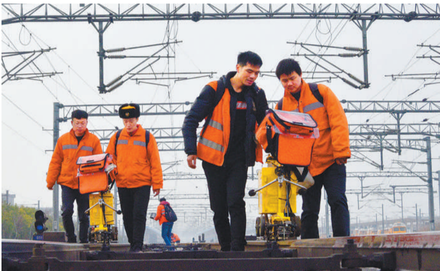
中国铁路南昌局集团有限公司南昌九江桥工段工人坚守岗位,加大检修力度,确保春运期间京九繁忙干线畅通。 王浩摄(中经视觉)
