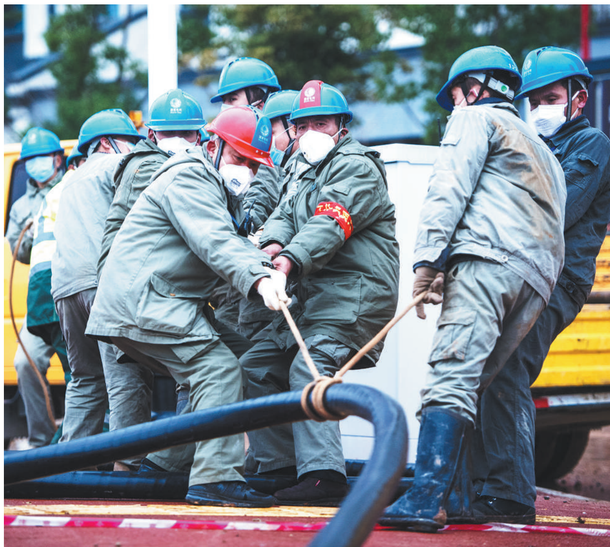
1月26日,武汉雷神山医院建设工地,来自武汉供电部门的工人在架设电路。1月25日下午,武汉市新型冠状病毒感染的肺炎疫情防控指挥部召开调度会,决定除武汉蔡甸火神山医院之外,半个月之内再建一所应急医院——武汉雷神山医院。雷神山医院初定新增床位1500张,建筑面积约3万平方米,可容纳2000名医务人员工作。新华社记者 肖艺九摄
