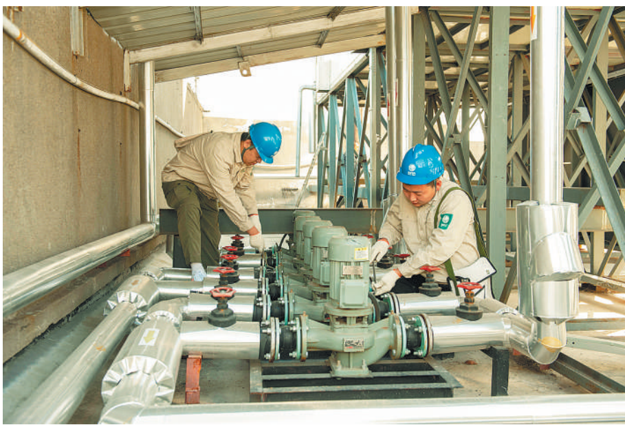
11月15日，国网泰州供电公司员工在靖江国际大酒店检查气能循环泵进出水阀门运行情况。当日，靖江市政府和国网江苏综合能源服务有限公司签订综合能源服务战略合作协议，对靖江国际大酒店蓄热蓄冷技术等综合能源服务项目推广实施。据悉，该项目今年3月开工建设，运行后预计中央空调节能节省24%，热水耗能节省68%。倪杰摄(中经视觉)
