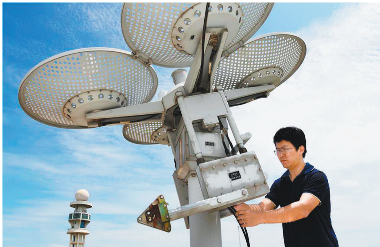
孙立在调试永兴岛上的观测设备。
