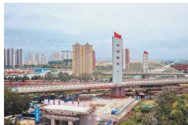
图为转体前的保定乐凯大街南延工程转体斜拉桥。(资料图片)
