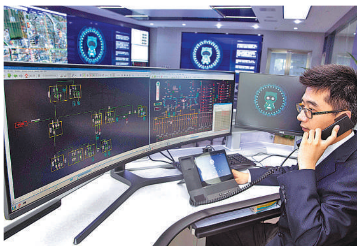
7月15日,工作人员与人工智能指挥员“小艾”现场互动。当日,国内首个供电服务人工智能指挥员“小艾”在国网扬州供电公司正式“入职”,“小艾”融合了语音识别、图像识别、流程自动化等功能,能够开展抢修指挥工作,显著提升效率。 汤德宏摄(中经视觉)
