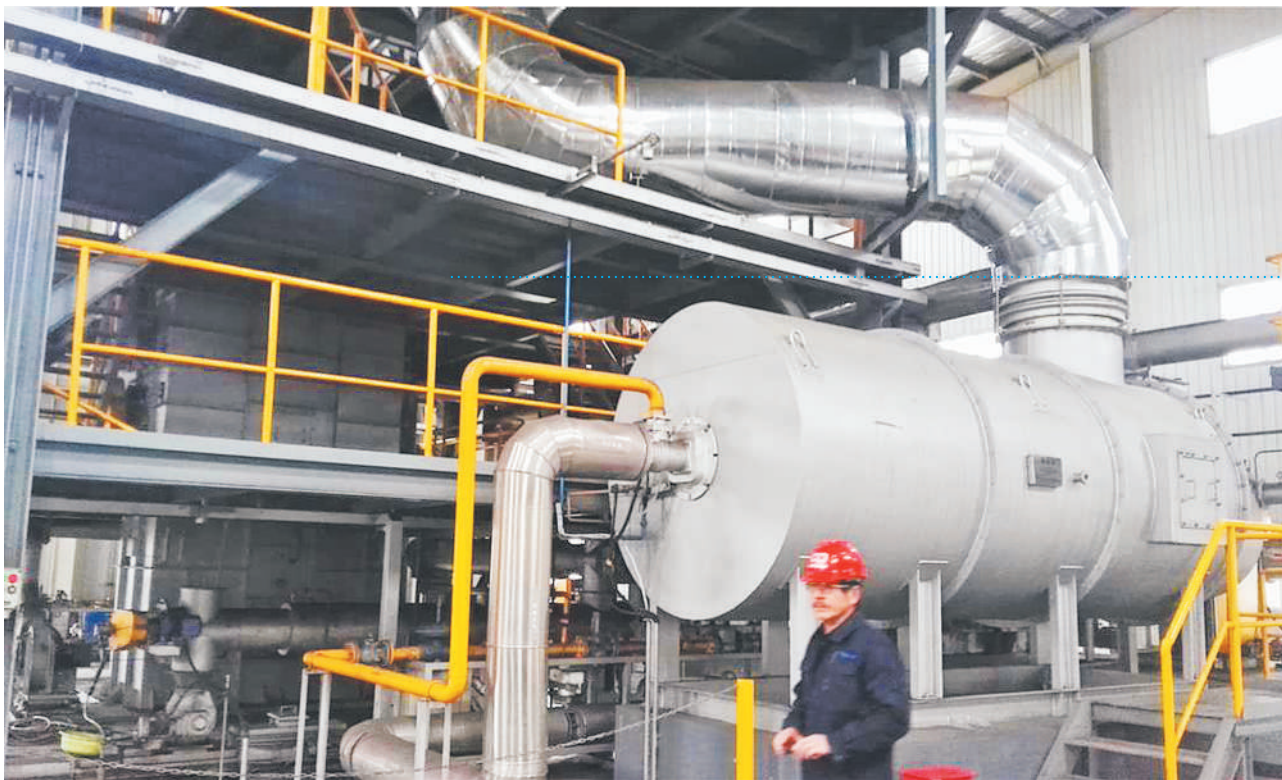
图为位于湖北省鄂州市的污泥碳化处理中心。该中心由中国节能旗下企业建设,污泥日处理量达60吨,单套设备处理能力全国第一。
