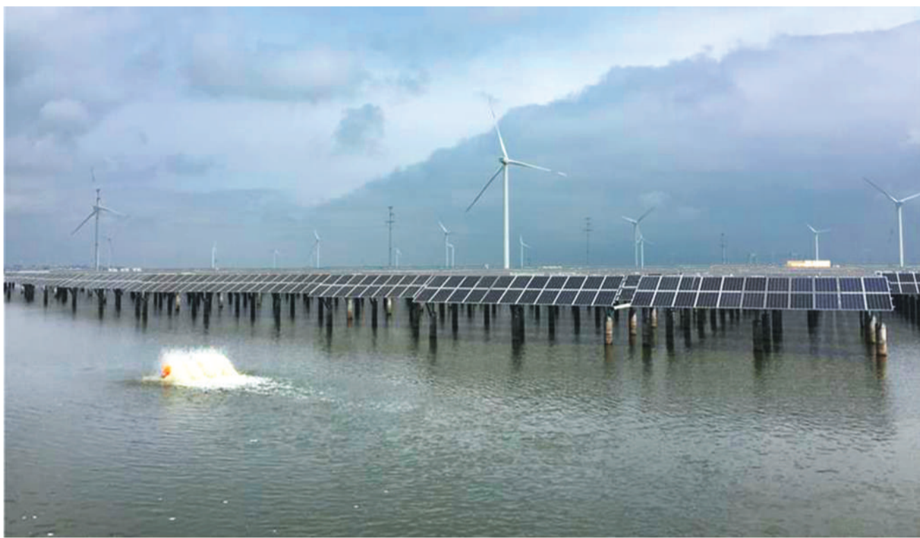
图为通威集团江苏如东10兆瓦渔光一体光伏项目。
