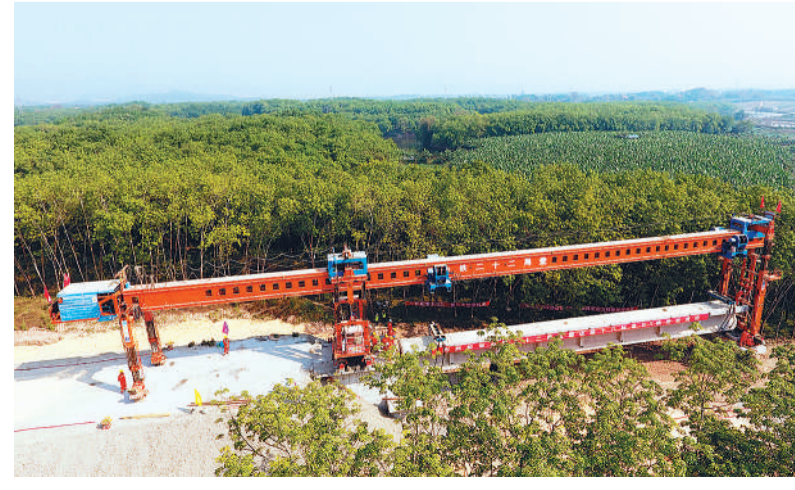
图为高空俯瞰绿色丛林中的中老铁路国内段第一长桥——玉(溪)磨(憨)铁路橄榄坝特大桥建设现场。
