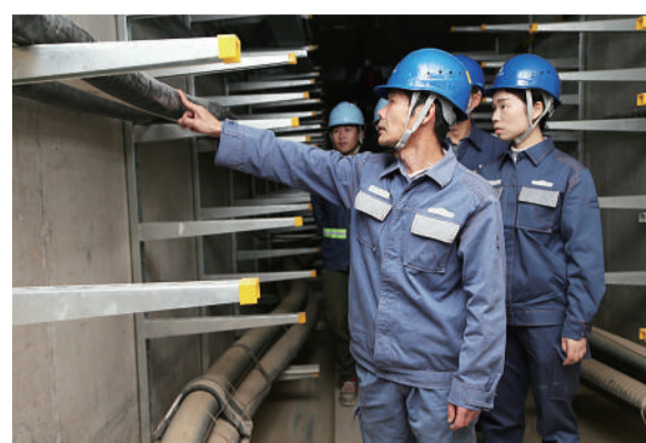
南方电网广东肇庆供电局电缆班班长黄建伟(左)正对地下综合管廊开展巡查。 林佩蕊摄
