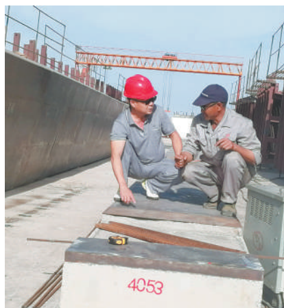
塞内加尔“方久尼大桥”援建工地现场，技术人员进行交流。(资料图片)
