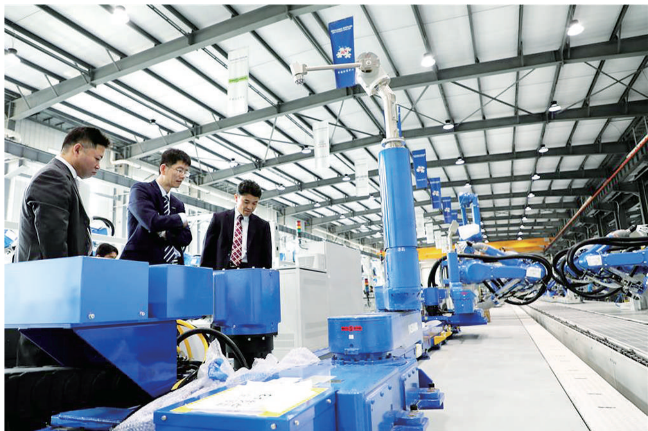
12月21日，河北香河县安川郡林机器人应用设备有限公司，工作人员在查看新安装的生产设备。近年来，香河县利用京津冀协同发展的战略机遇，加快打造机器人小镇。目前，香河机器人小镇入驻企业已达130余家，其中有80%来自北京，今年该县机器人产业产值有望超13亿元。 王晓刚摄
