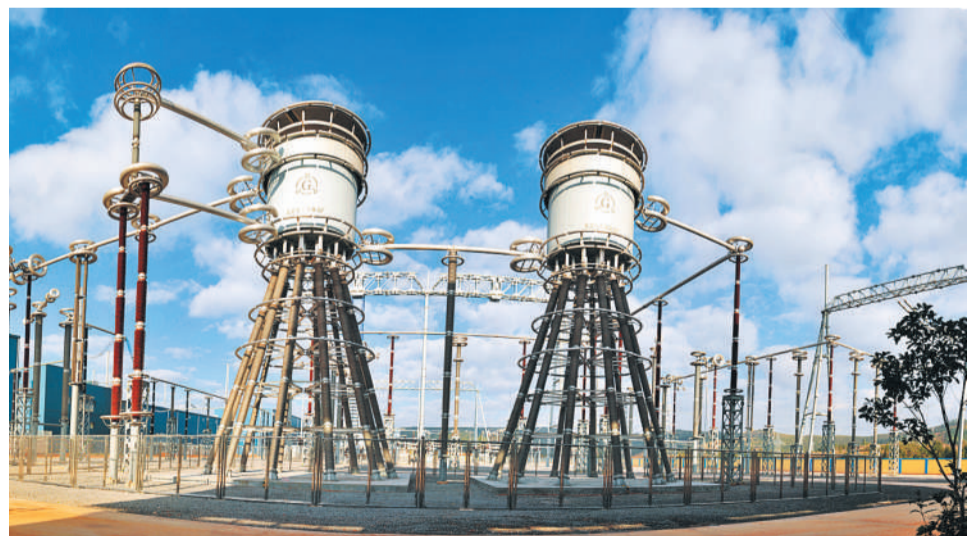
世界领先的±800千伏特高压直流工程——云广特高压直流工程送端楚雄换流站直流场设备。
