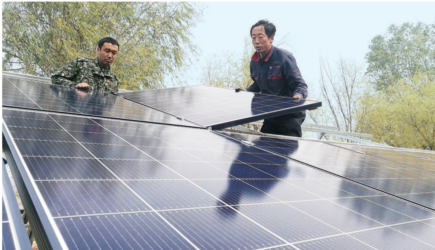
在碱厂乡蒋家村,村民正在加紧建设装机容量为50千瓦的光伏发电扶贫项目。
