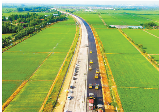
7月12日，国道347（铜陵段）一标段，安徽路桥公司施工人员正在作业。据介绍，国道347（铜陵段）建设已进入冲刺阶段，争取国庆节前实现通车。 过仕宁摄
