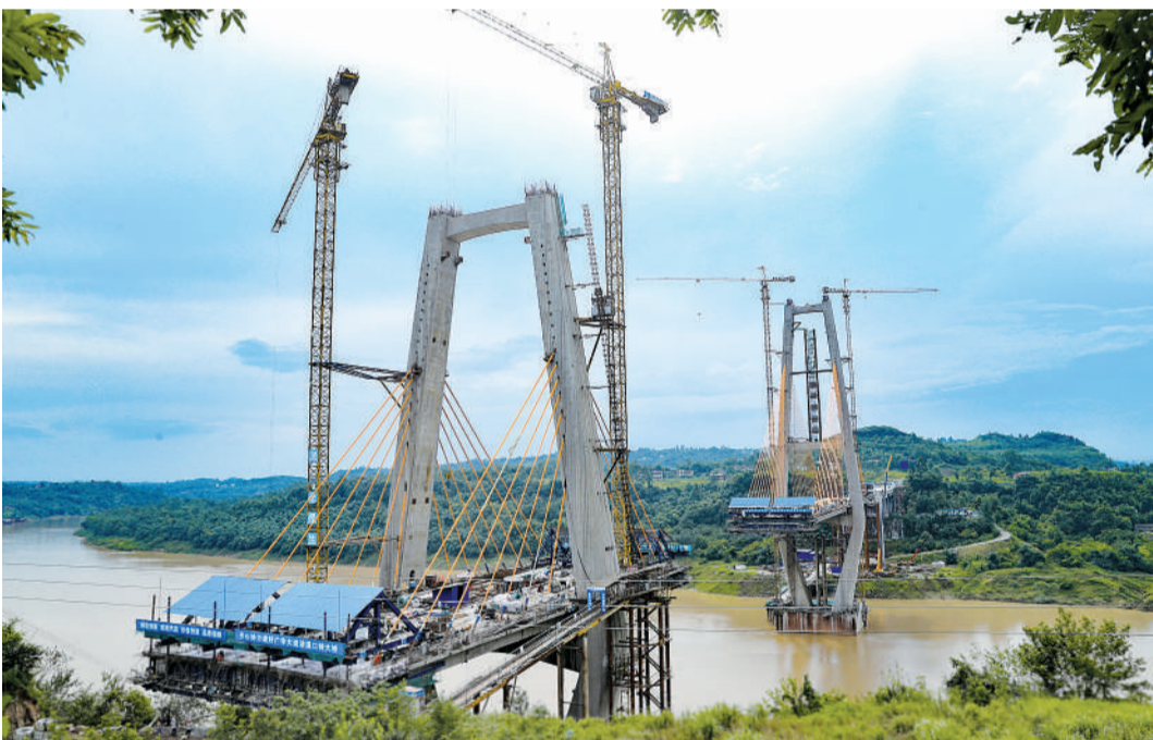
6月25日,正在加快建设的华岳快速通道清溪口渠江特大桥。华岳快速通道清溪口渠江特大桥,是四川省连接华蓥、广安、岳池三座城市的重点控制性“咽喉工程”,建成后,将缩短广安、岳池、华蓥三地的通行距离,对拉动整个广安地区经济社会发展具有重要作用。邱海鹰摄
