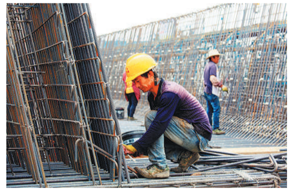
6月18日,在山东省临沂市平邑县王家洼村中铁十九局鲁南高铁制梁场,员工在安装混凝土箱梁钢筋笼。当日是端午节,中铁十九局鲁南高铁制梁场的职工们依然坚守在工作一线。
