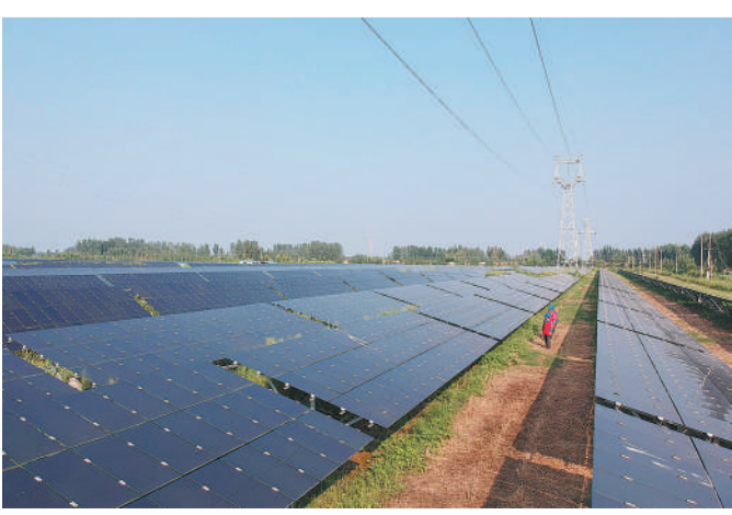
端午假日期间,国网山东禹城市供电公司工作人员来到当地发电企业建设的光伏电站开展设备巡视,帮助光伏发电企业在夏季用电高峰到来前消除安全隐患。 崔商明摄
