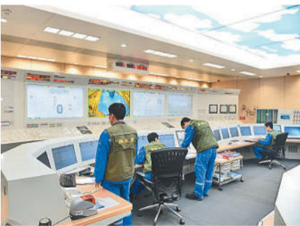
因为中国广核集团阳江核电站数字化仪控系统控制室。本报记者 杨阳腾摄
