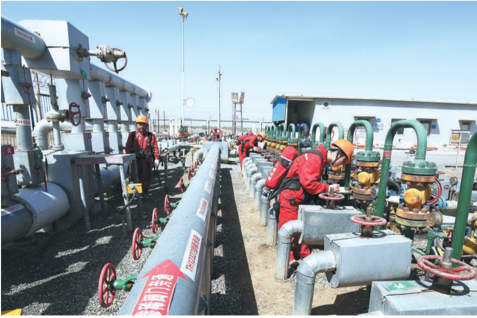
5月25日，位于新疆轮台县的西北油田采油二厂员工在录取单井生产进站压力和掺稀油量数据。日前，西北油田采油二厂“注氮气+掺稀”并进转站技改项目投产成功，实现了安全、环保、增效三丰收。胡 强摄
