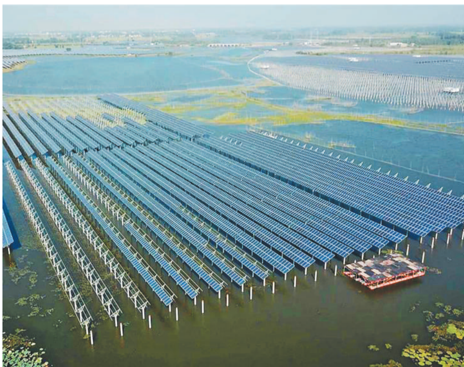
图为淮南潘集区田集水上光伏电站。
