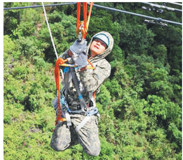
图为何坤在500千伏运行线路上完成更换绝缘子任务后，利用吊篮法离开电场的瞬间。
