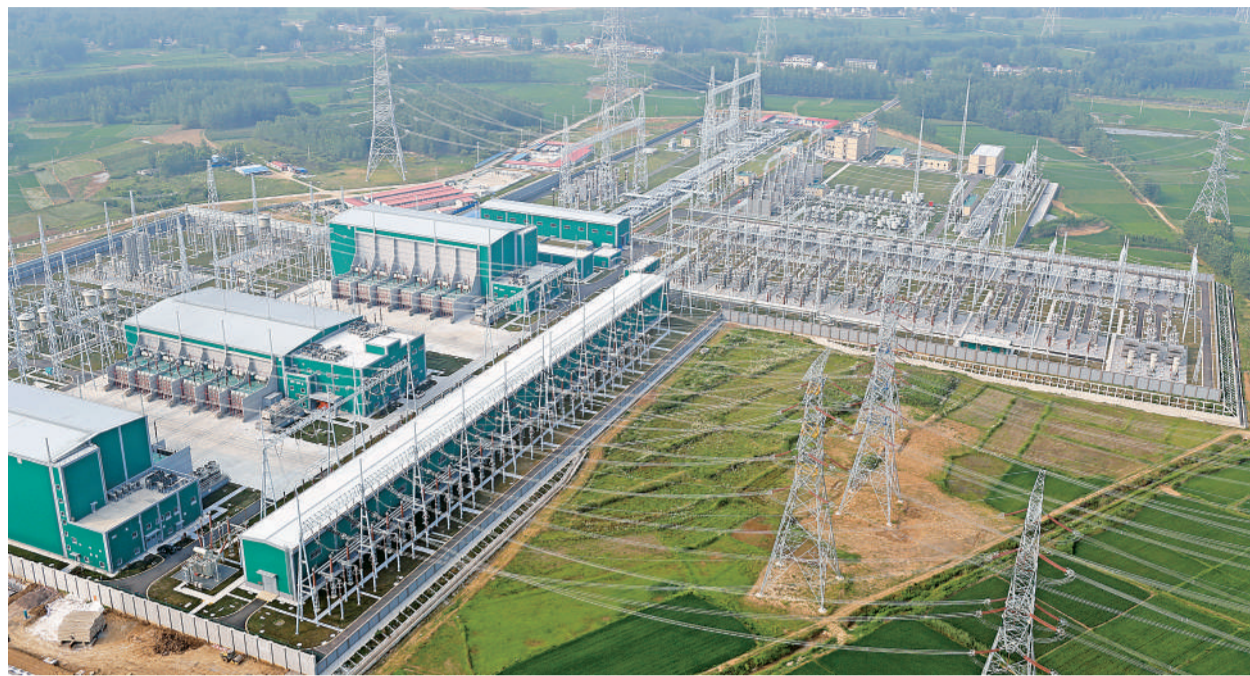
特高压直流输电线路工程扎鲁特换流站。
