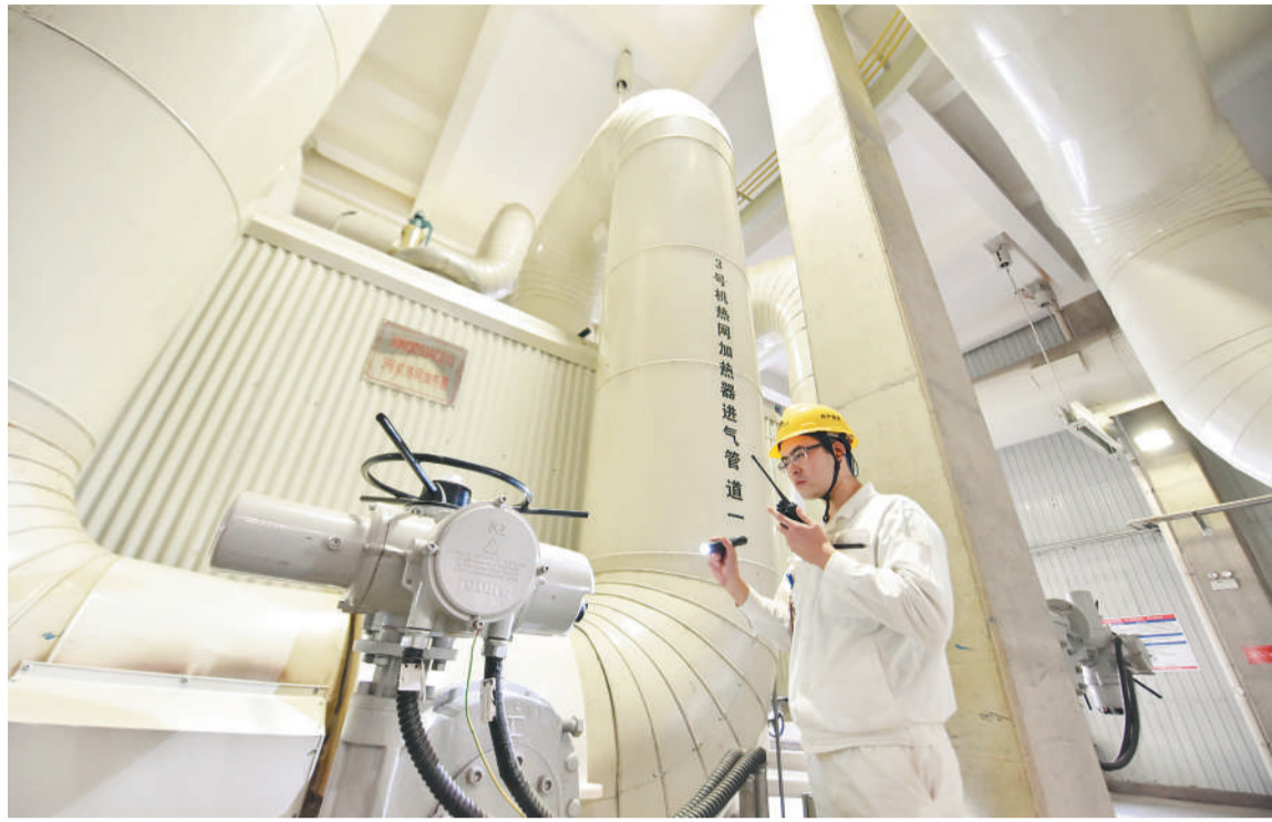
工作人员在国华定州电厂对热网加热器进行检查。近年来,为改善区域空气质量,河北省定州市实施燃煤锅炉淘汰和提升改造工程,加快推进城区电厂集中供热工程。工程以国华定州电厂4×600兆瓦机组供热改造作为集中供热热源,规划铺设管网90公里,新建热力站98座。
