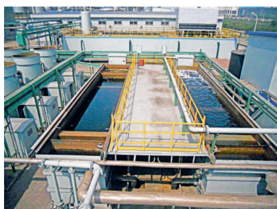
首钢京唐钢铁联合有限责任公司焦化废水深度处理电絮凝与电气浮装置
