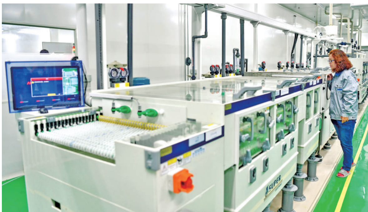
图为工人在唐山市古冶区超精细挠性电子线路板及刚柔结合板项目生产线上工作。日前,河北省唐山市古冶区利用关停的高耗能、高污染耐火砖厂厂房改造成的超精细挠性电子线路板及刚柔结合板项目投产。
