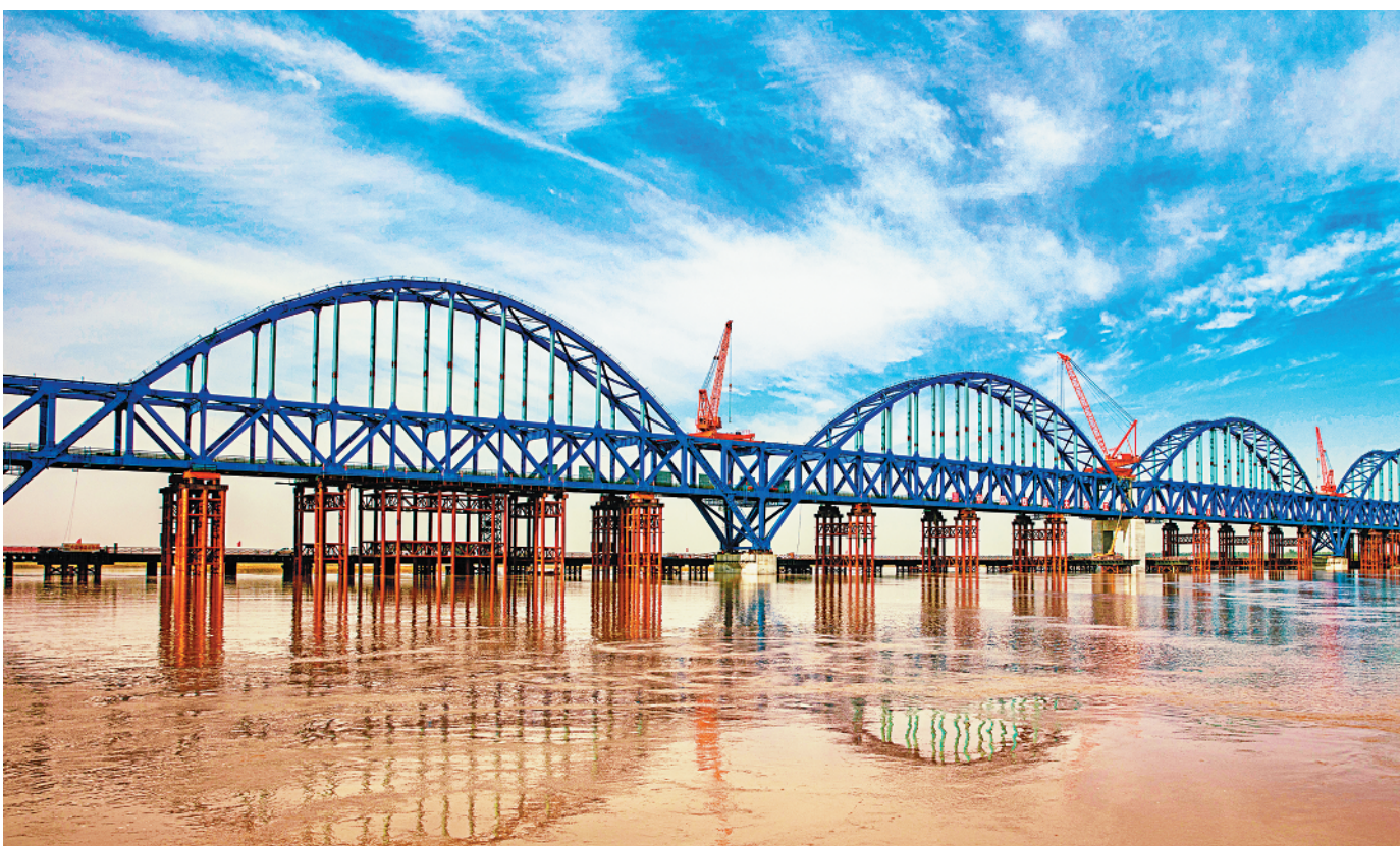
9月30日,由中国铁建大桥工程局承建的银(川)西(安)高铁银吴家专黄特大桥举行主桥落梁活动,标志着主桥施工圆满结束,为宁夏首条高铁提前建成通车创造了条件。 银西高铁是国家高速铁路网的重要组成部分。高铁全线通车后,从银川至西安车程将由目前的12小时缩短至3小时左右,对加快宁夏内陆经济开放试验区开发开放,振兴陕甘宁革命老区,促进沿线地区经济社会发展,深化国家“一带一路”建设具有重要意义。 陈树青 李仕兵摄影报道
