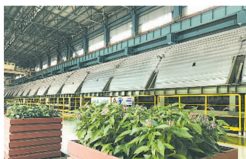
宝钢股份启动“烧结系统节能环保综合改造工程”,形成年产烧结矿2133万吨的总体产能规模,并实现了“高效、低耗、环保、节能”的烧结工艺定位。图为改造后的3号烧结机。
