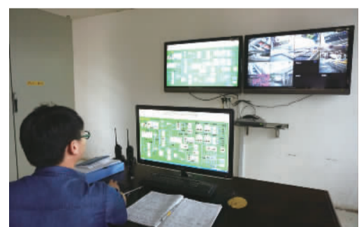
酒厂的污水处理站监控系统能够对污水处理的各个环节进行实时监测。
