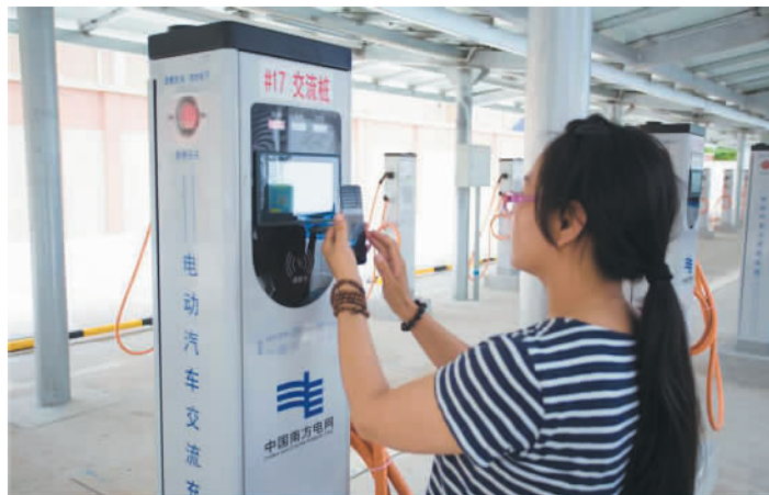
在深圳莲花山充电站，用户用手机扫码，就能完成充电交易。
