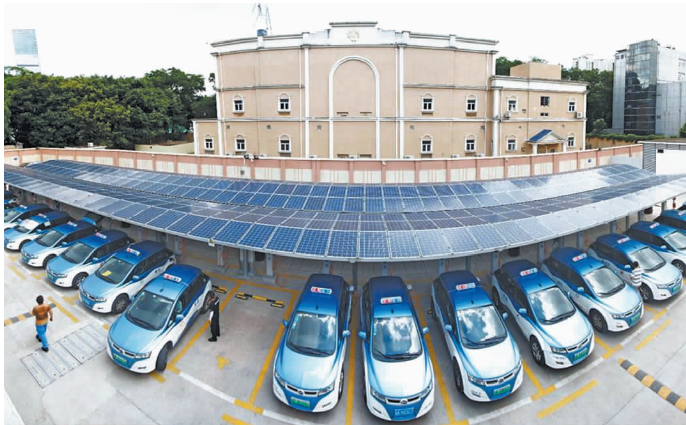
图为全国首个“变电站+充电站”站点——深圳莲花山充电站。
