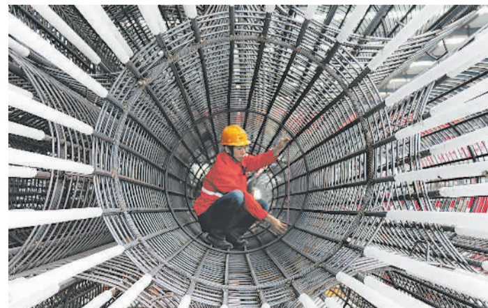
6月28日，中铁十一局郑万高铁5标2号钢构厂质检员在抽查钢筋质量。在郑万高铁建设中，项目各分部分别开展标准化管理示范岗争创活动，先后有9个工点、7个钢构厂和拌和站被授予“标准化管理示范(点)岗”。
