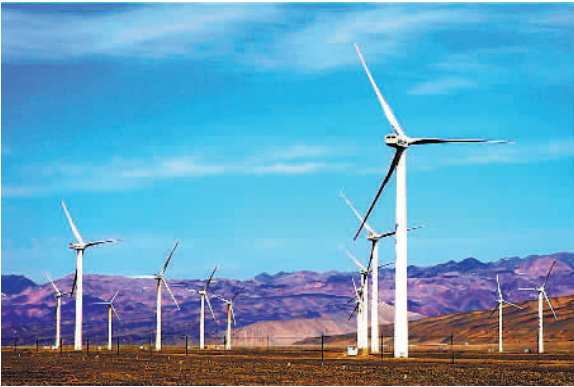
图为乌鲁木齐风电场一角。 本报记者 乔文汇报
