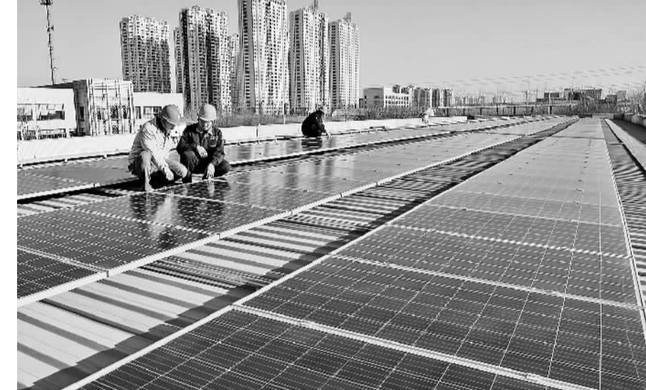
12月16日,电力工人在检查光伏发电板的质量。近日,河北省秦皇岛市亿嘉集集团一兆嘉建筑工程有限公司屋顶光伏电站并网投运。新华社记者 杨世尧摄
