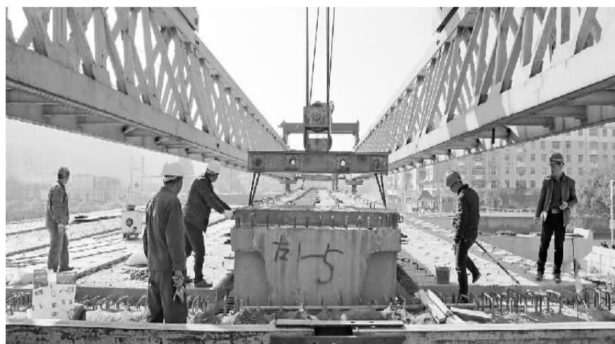
12月9日，江西大余县梅关大桥新建工程建设工地，工人正在架梁施工作业。据了解，该工程是大余县重点民生工程之一，桥梁总投资1400多万元...
