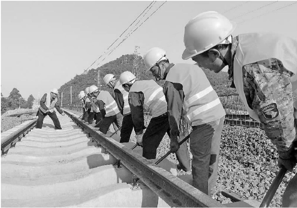
12月1日，中铁四局八分公司工人在南昆铁路南宁至百色段增建二线进行人工拔长轨作业。南昆铁路南宁至百色段增建二线全长210公里，计划2017年6月30日铺通。“南百二线”建成后，将大大增强南昆铁路南宁至百色段运输能力。郑红梅摄
