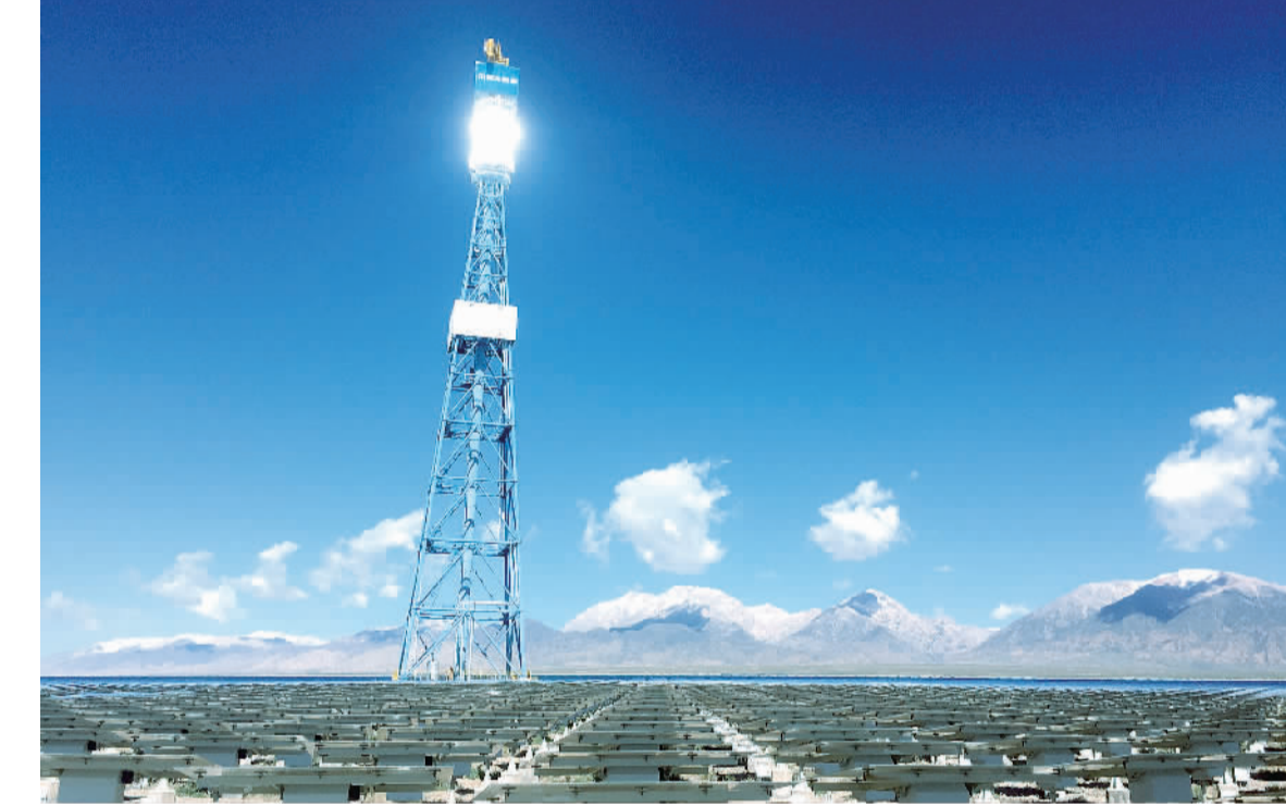
我国首批20个太阳能热发电示范项目,分布在青海、甘肃、河北、内蒙古和新疆。图为青海省中控德令哈一期10兆瓦塔式太阳能热发电项目正在运行中。
