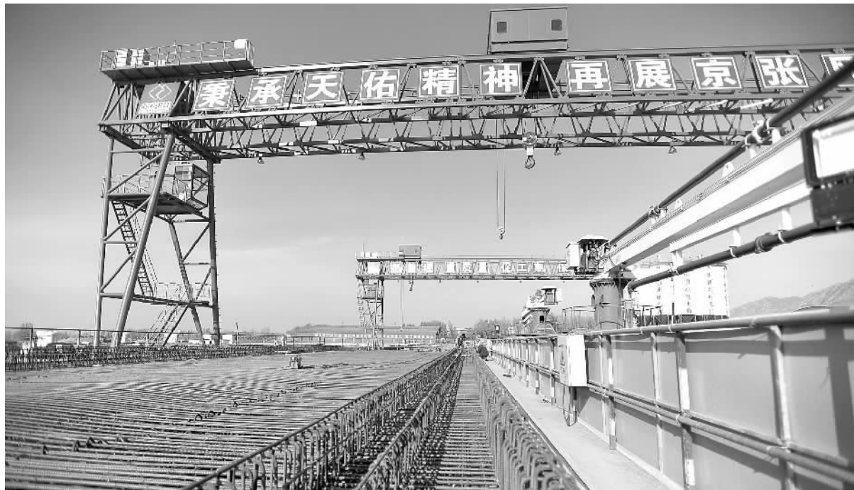
11月2日，工人在京张城际高速铁路张家口宣化境内龙洋河特大桥制梁工地上施工。北京冬奥会重点配套交通工程——京（北京）张（张家口）高速城际铁路工程目前稳步推进。京张城际高速铁路又名京张高铁，全长约174千米，预计2019年12月通车。
