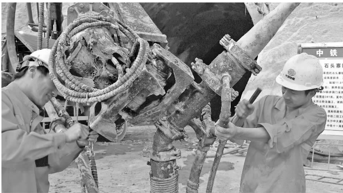
11月4日,中铁十一局玉磨铁路项目部工人正在维修设备准备施工。玉磨铁路是云南通往老挝、缅甸、泰国、马来西亚和新加坡的泛亚国际大通道,也是“一带一路”建设重要项目工程。工程在云南境内全长500多公里,起于玉溪,经普洱,到西双版纳磨憨口岸出境,今年5月全线开工以来,施工有序推进。 郑涛海摄
