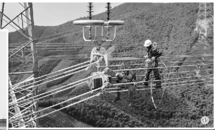
图③ 国网湖州供电公司完成1000千伏浙福线湖州段的竣工验收工作。（资料图片）
