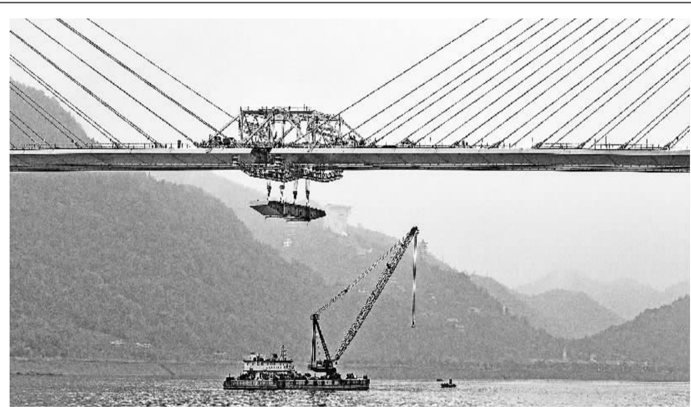
10月15日,重庆丰都长江二桥最后一块钢箱梁吊装完毕,桥面顺利合龙。据了解,由路桥华东工程有限公司承建的丰都长江二桥总投资12.9亿元,于2010年11月正式开工建设。该桥全长2165米,主桥长1466米,主跨跨径680米,是目前西南地区最大跨径双向四车道双塔双索面钢箱梁斜拉桥。2016年底建成通车后,将进一步拓展城市空间,缓解城区交通压力,拉动丰都南北两岸经济社会和旅游产业协调发展。 熊波摄
